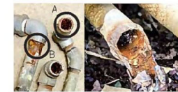
A → 管内壁のさびは赤水の原因に。 B → 継手部分のさびは水漏れの原因に。
